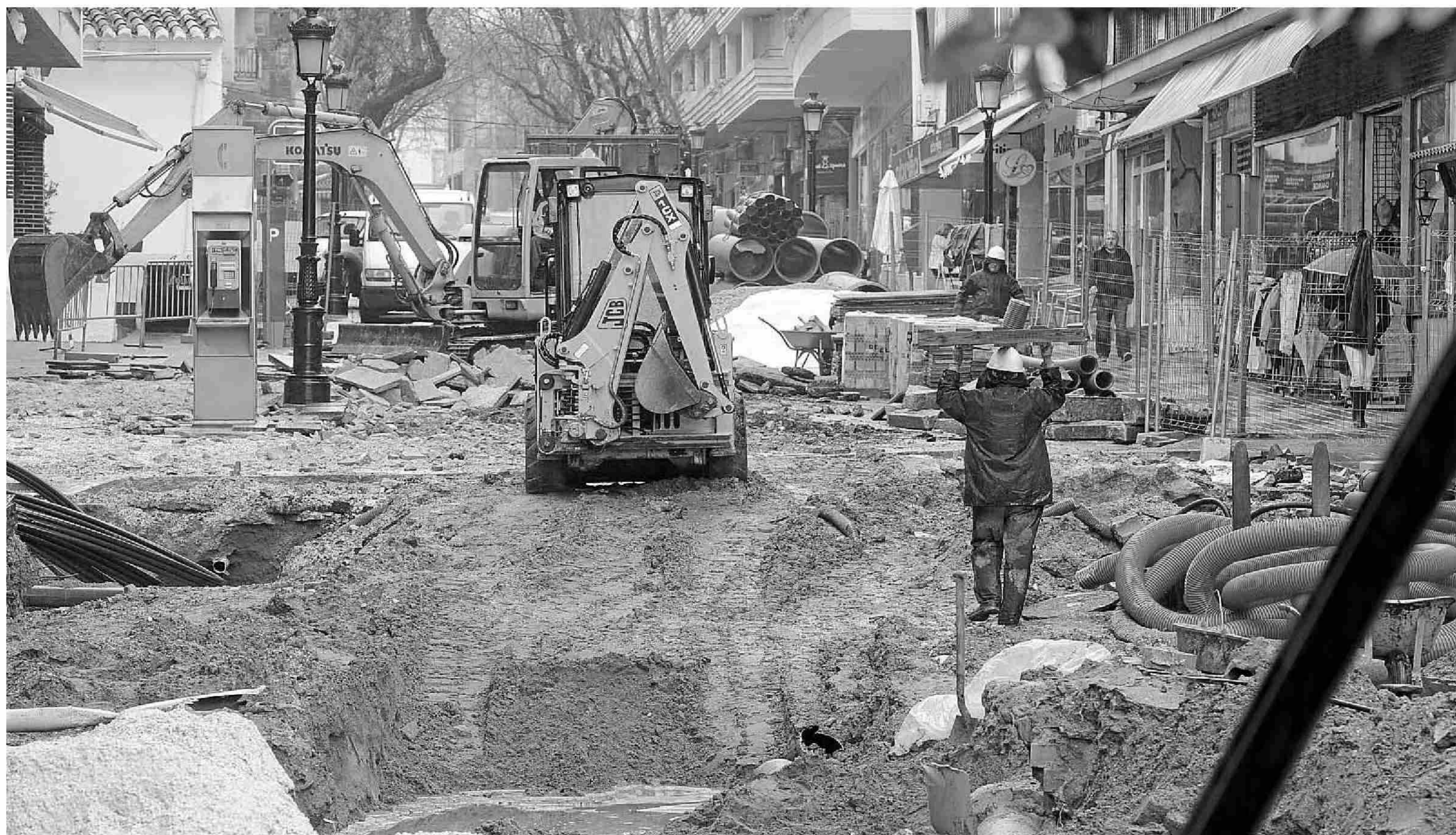
Los trabajos para el cambio de canalizaciones han arrancado esta semana. :: JOSELE-LANZA
