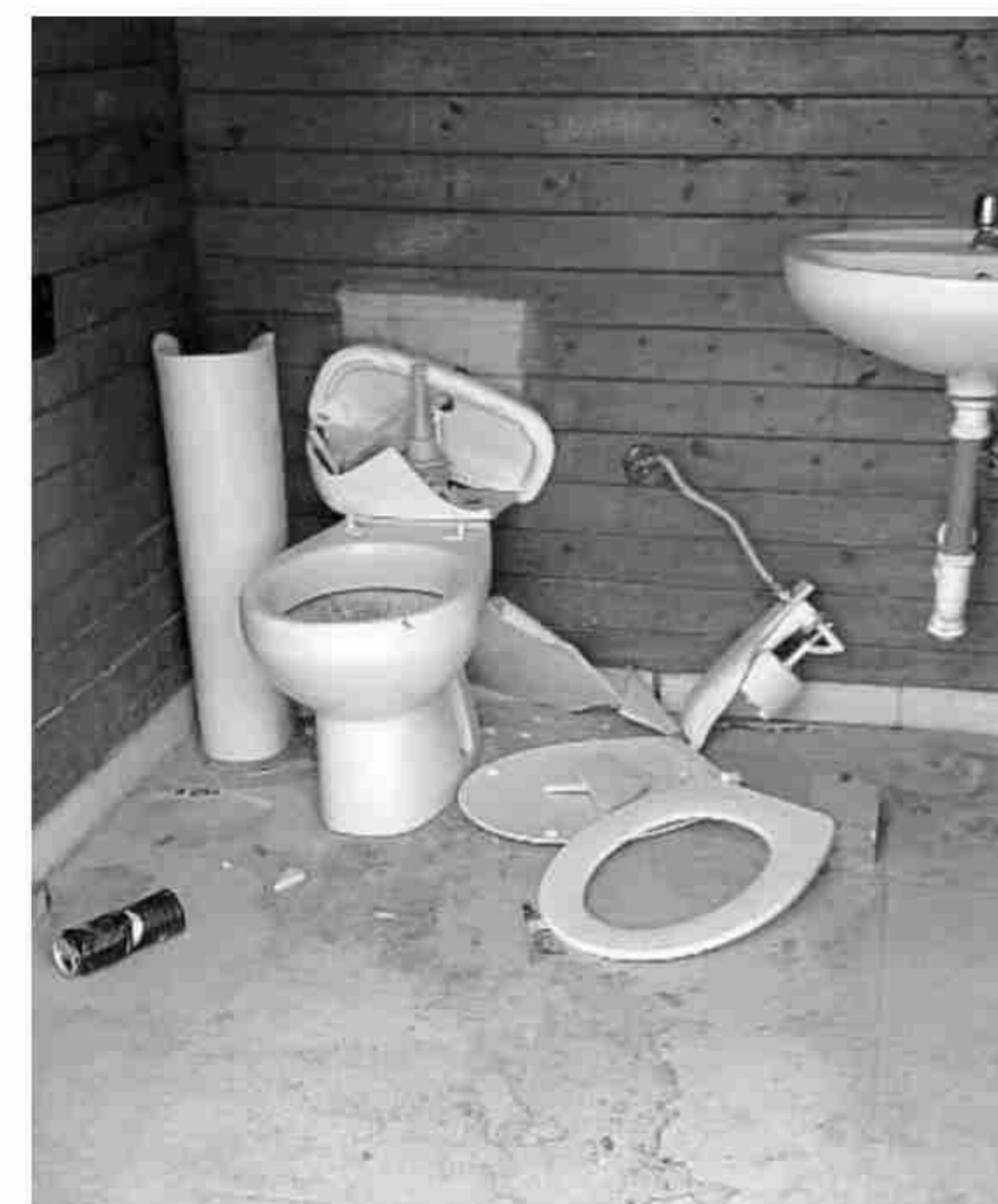
Estado de uno de los baños. :: s. v.
