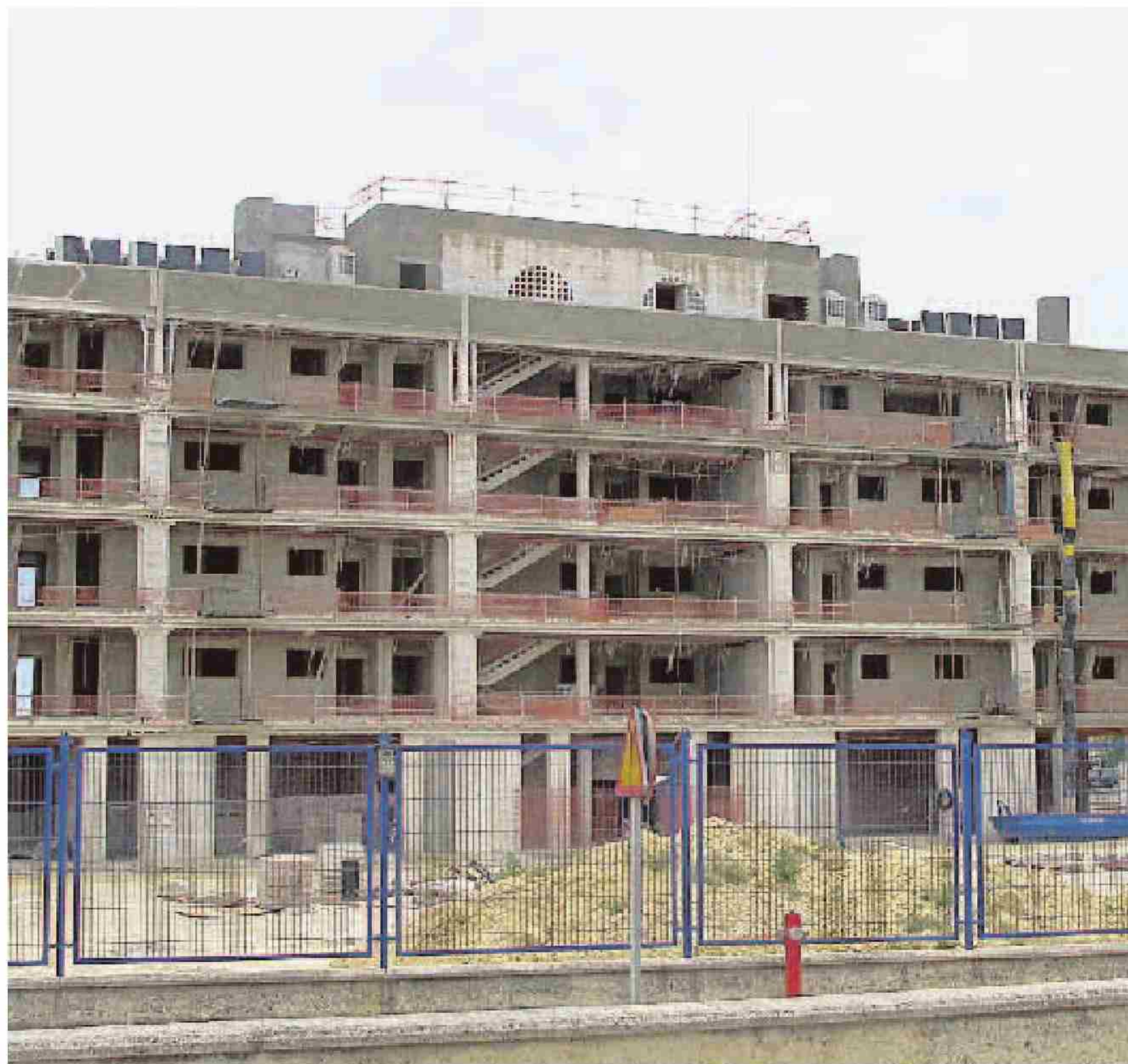
Los trabajos no han experimentado avances en al menos dos meses. :: L.R.
