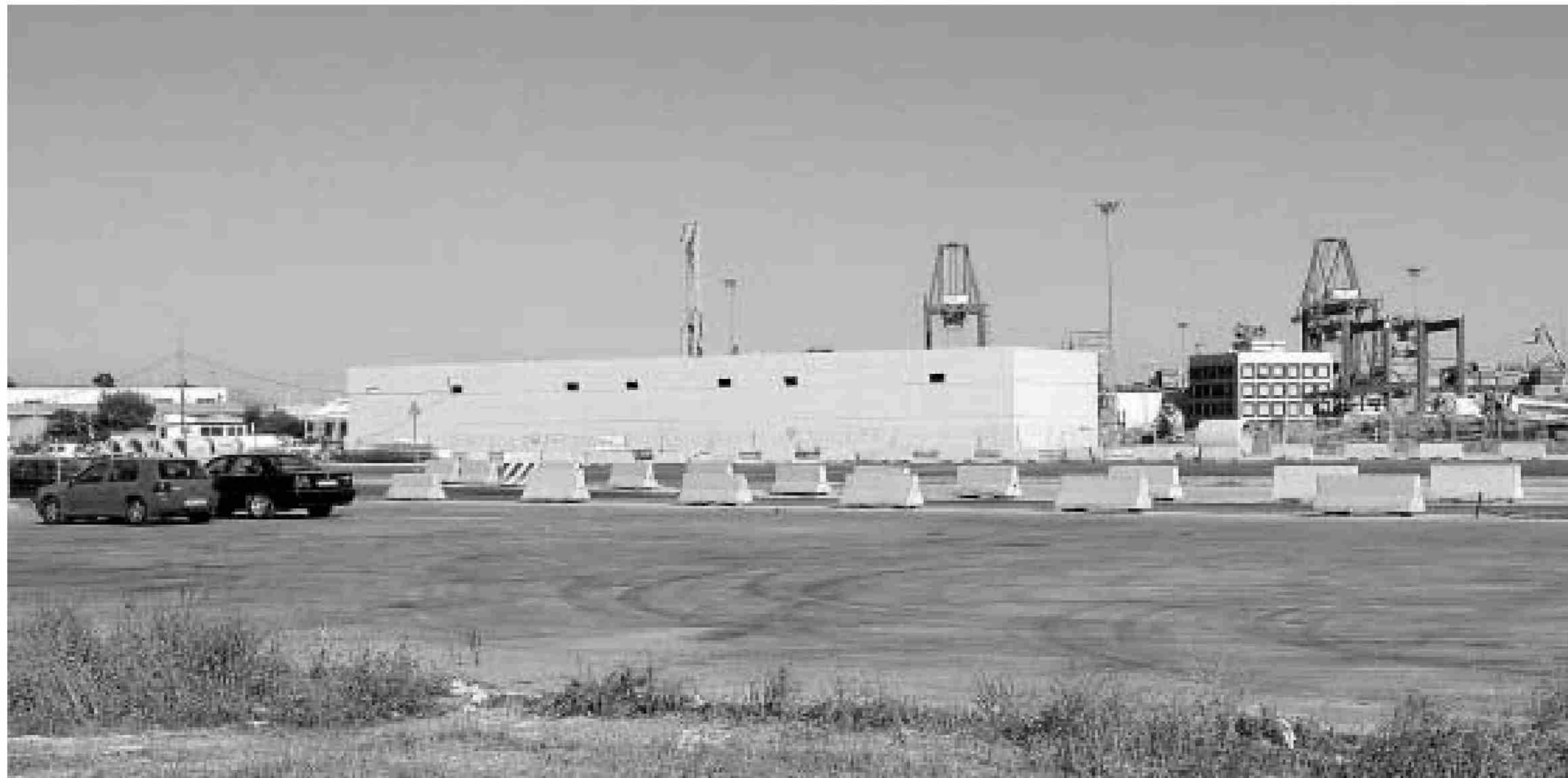
Nueva estación de bombeo de aguas residuales que se está construyendo en el puerto de Málaga.
