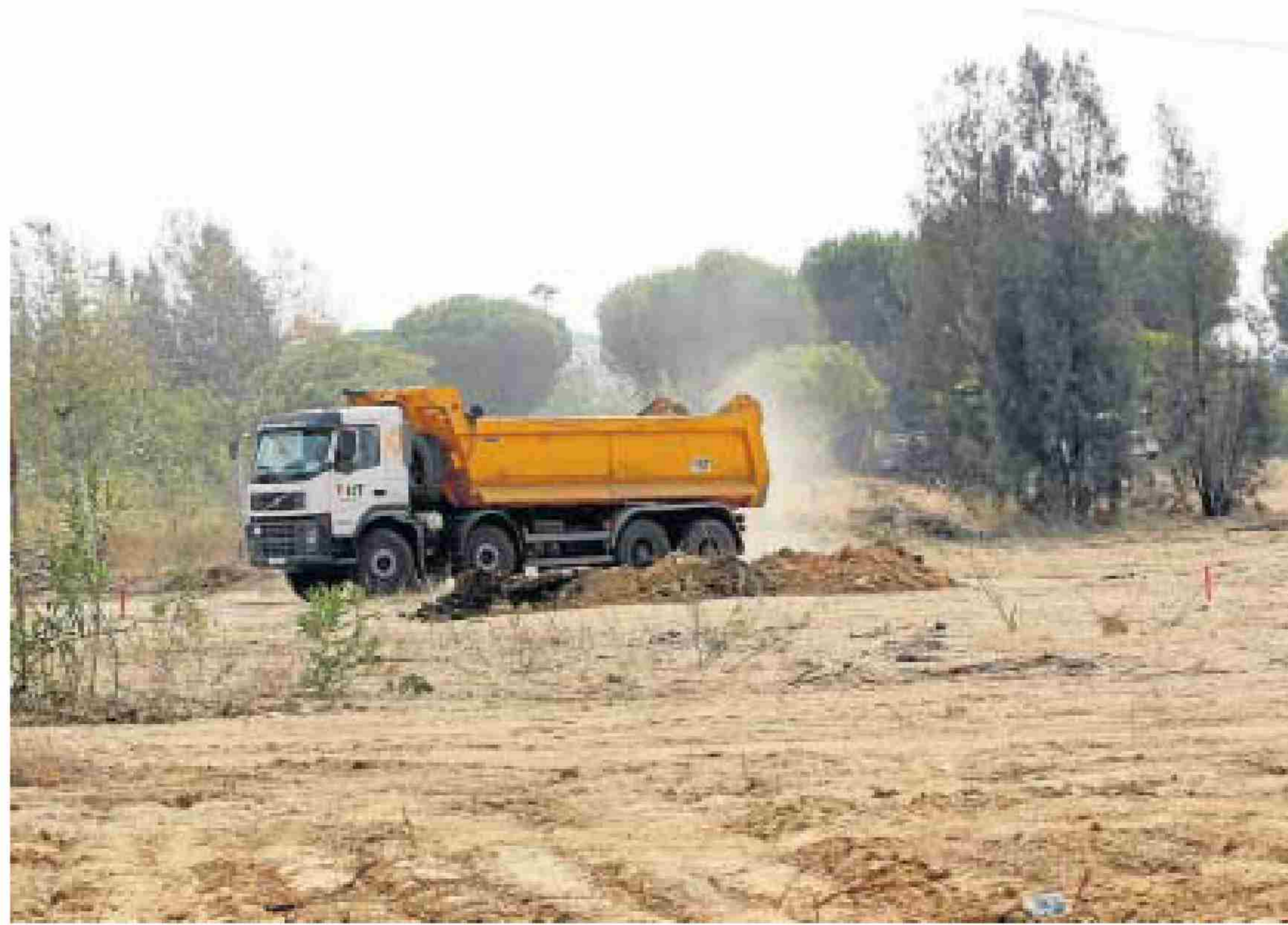
Un nuevo dispositivo de obras inició ayer los movimientos de tierra en el futuro Parque Sur.
