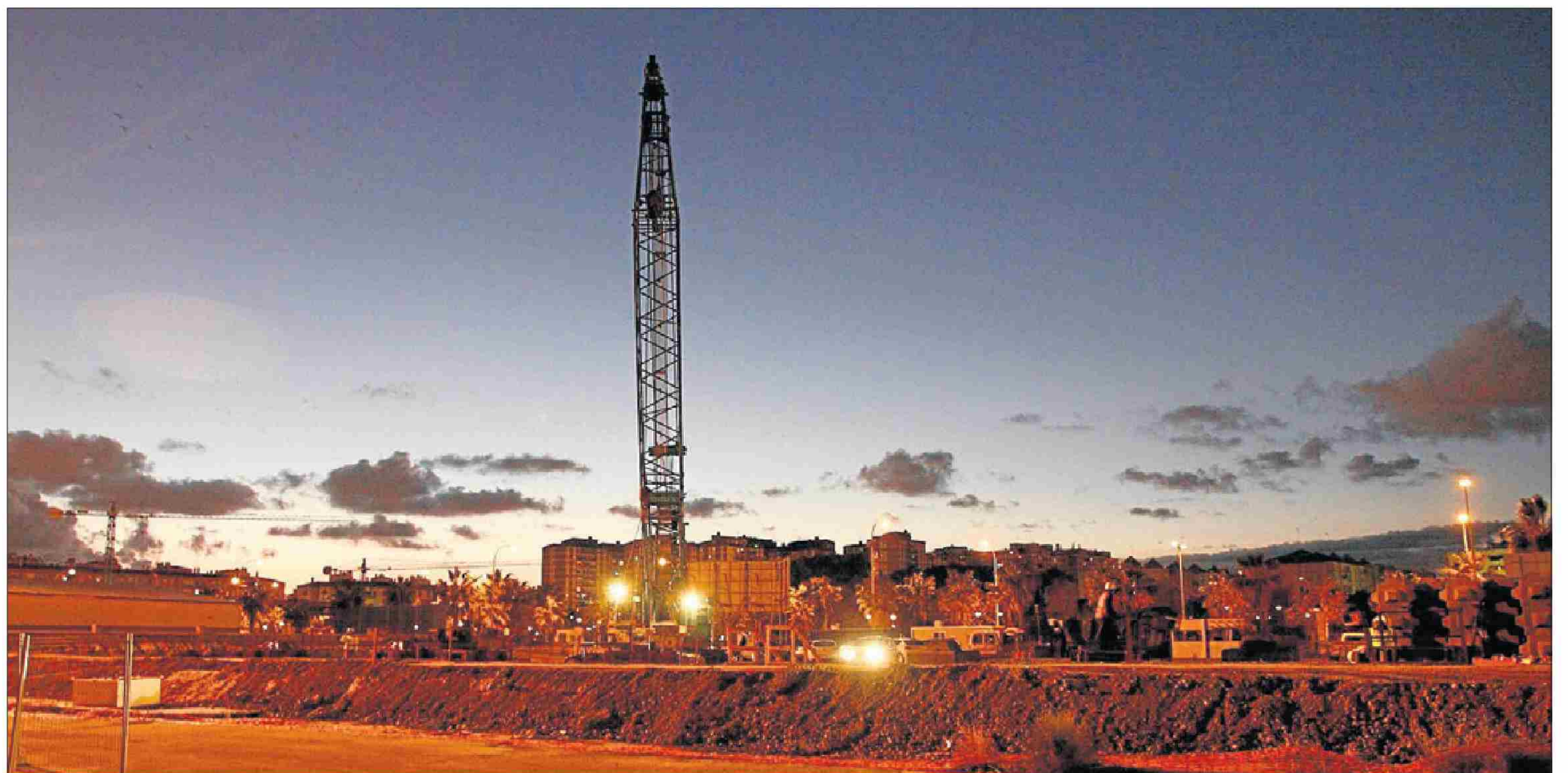
Vista de las obras que se están acometiendo en la plataforma de San Andrés para habilitar nuevos accesos. ARCINIEGA
