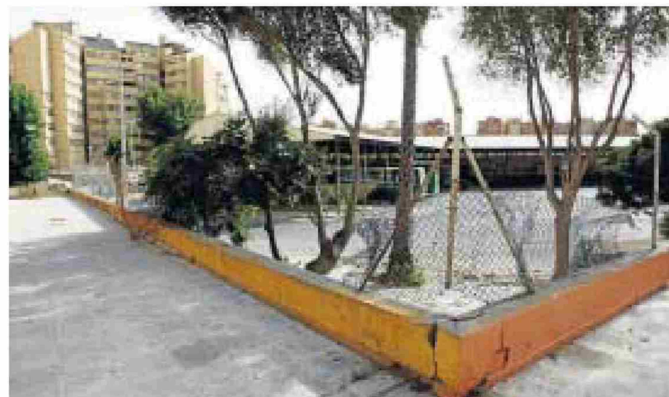
Imagen del estado actual del cerramiento.
